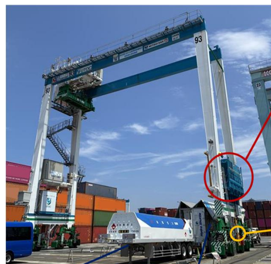
水素トレーラー
