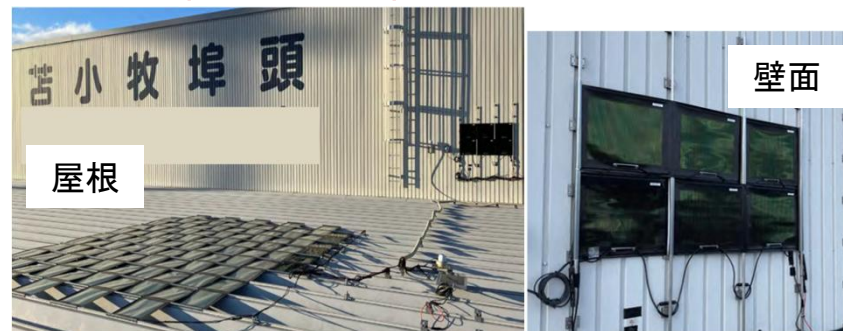
港湾施設で実証中のペロブスカイト太陽電池(苫小牧港)
