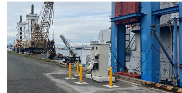
作業船向けに導入されている陸上電力供給設備(名古屋港)
