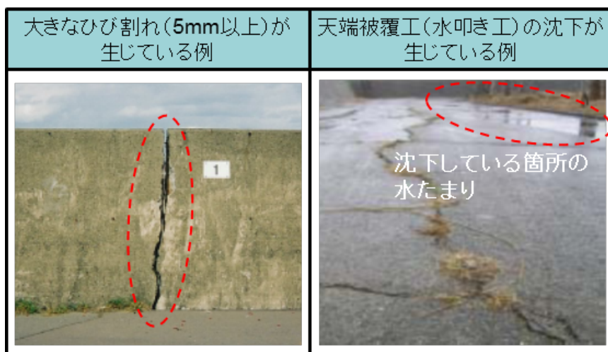
図-3.1 巡視（パトロール）において確認する特徴的な変状の事例
