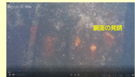
撮影事例(鋼矢板) 鋼面の発錆
