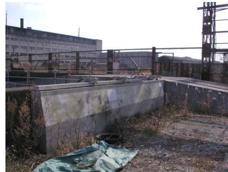
車の利用のある陸閘は廃止し、通行可能なスロープを設置した事例(種崎地区)
