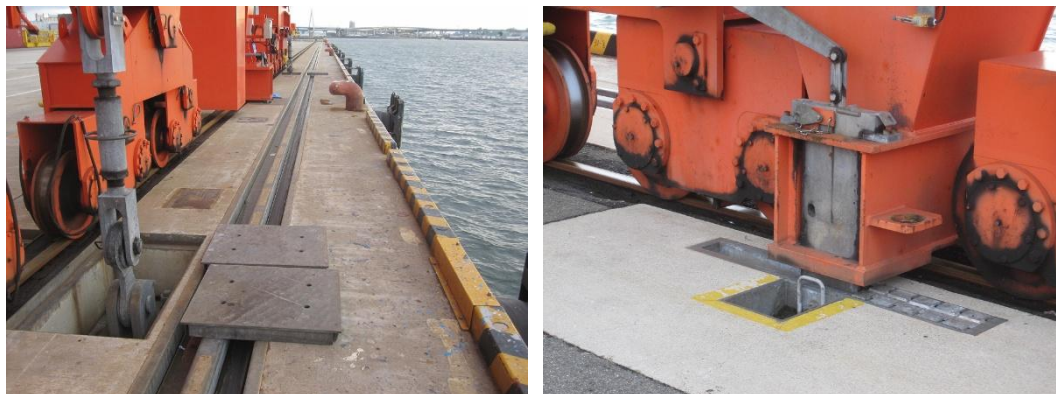
写真 3.5.1 ガントリークレーンの転倒・逸走防止アンカーの設置例
