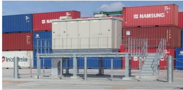
写真 3.1.1 電気設備を嵩上げ (津波対策)
