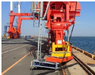
写真 2.5.1 ケーブルリールの落下状況
