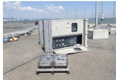
写真 2.2.4 屋外電気設備の被害
