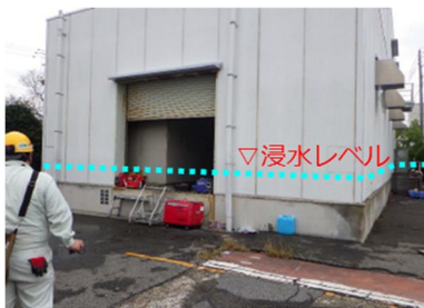
写真 2.2.1 受電所の浸水 (床上約 30cm)
