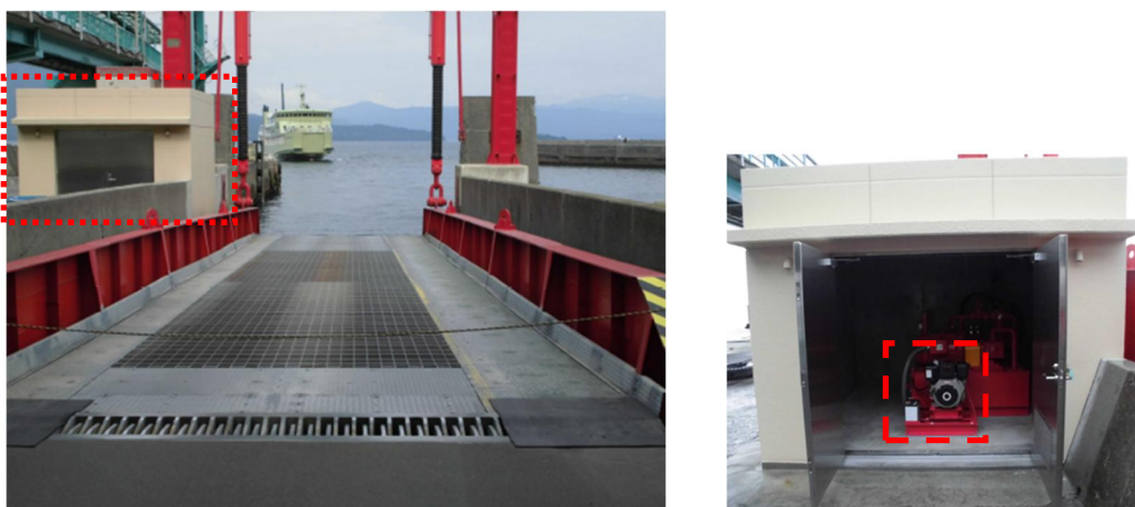
写真 3.4.1 可動橋用の非常用電源の設置事例（左が油圧ユニット室、右が非常用電源）
