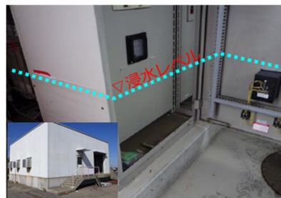
写真 2.2.2 現場変電所の浸水
