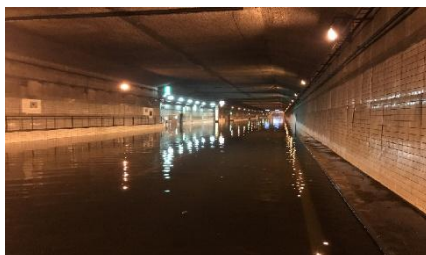
写真 2.6.3 海底トンネルの冠水
