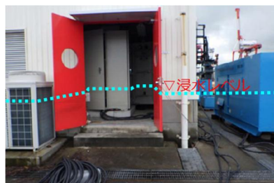
写真 2.2.3 現場変電所の浸水
