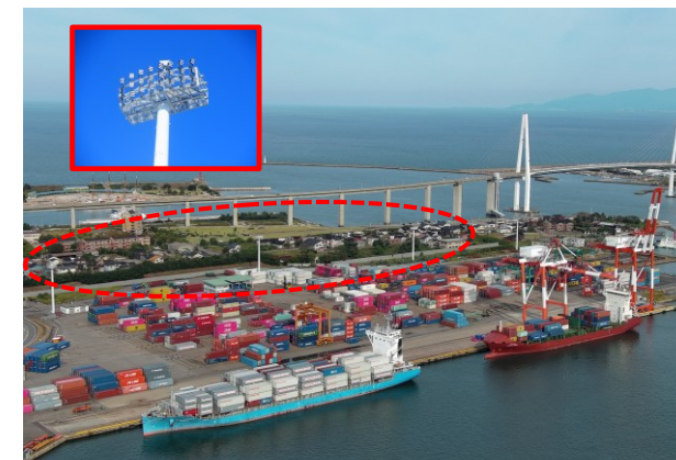
ヤード内の L E D 照明
