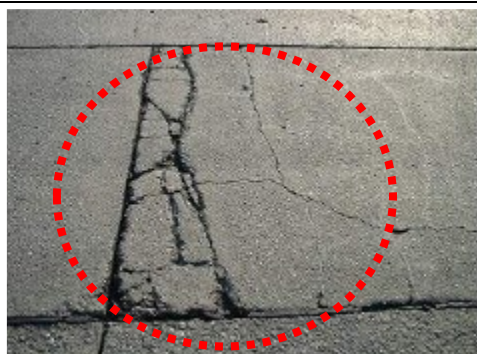
写真 2-05 : 劣化度判定 『a』
