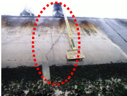
写真 4-04：劣化度判定『b』
