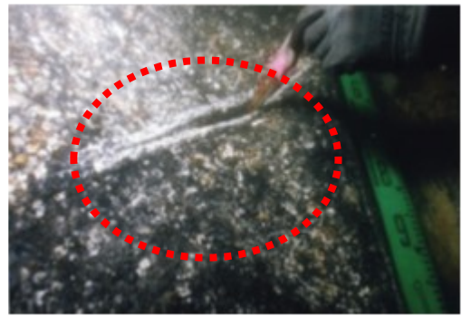
写真 1-04 : 劣化度判定『a』
