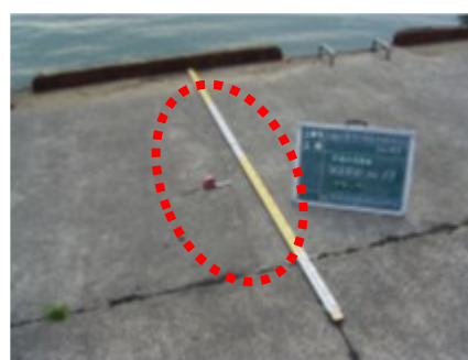
写真 4-10 : 劣化度判定 『c』
