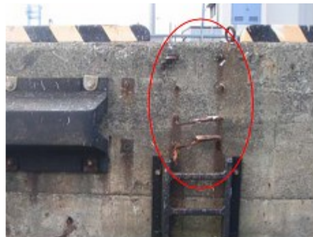
写真 6-04：劣化度判定『a』
