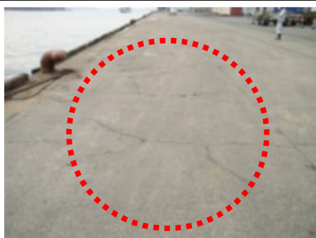
写真 2-06 : 劣化度判定 『b』
