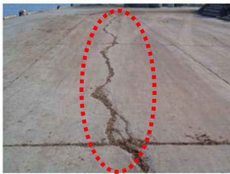
写真 2-01 : 劣化度判定 『a』
