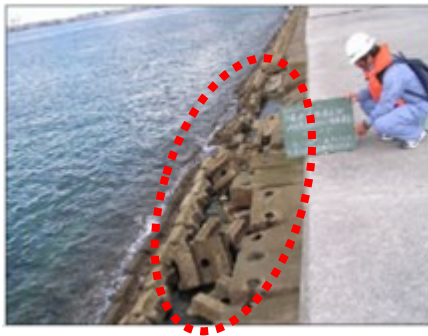
写真 5-01：劣化度判定『a』
