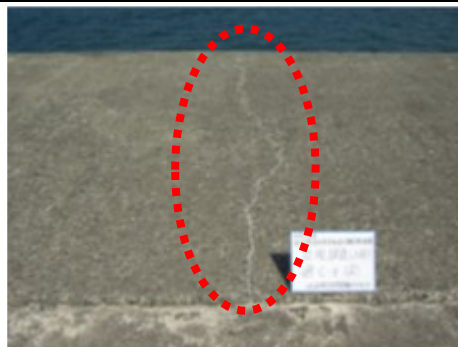
写真 3-13 劣化度判定 『c』
