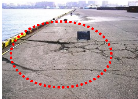
写真 2-04 : 劣化度判定 『a』
