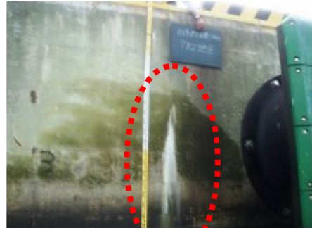
写真 4-12 : 劣化度判定 『c』
