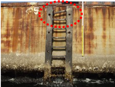
写真 6-01：劣化度判定『a』
