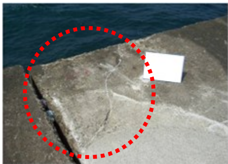
写真 3-12 : 劣化度判定 『c』
