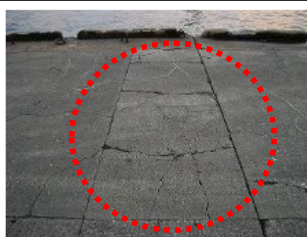
写真 2-07 : 劣化度判定 『b』
