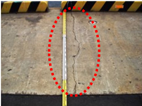
写真 4-01：劣化度判定『b』
