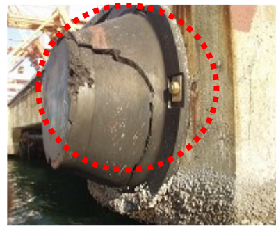
写真 5-04 : 劣化度判定 『a』
