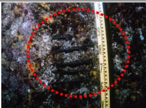
写真 3-02 : 劣化度判定 『a』
