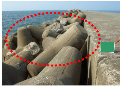
写真 4-02：劣化度判定『b』
