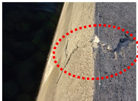
写真 3-11 劣化度判定 『c』
