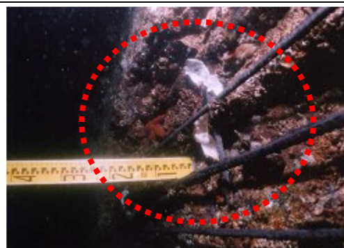
写真 3-03 : 劣化度判定 『a』
