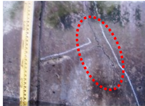
写真 4-14 : 劣化度判定 『c』
