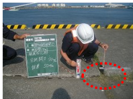
写真 2-02 : 劣化度判定 『a』
