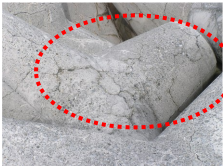
写真 4-03：劣化度判定『c』
