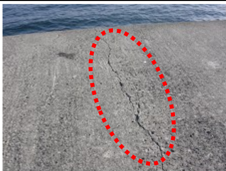
写真 3-10 : 劣化度判定 『c』
