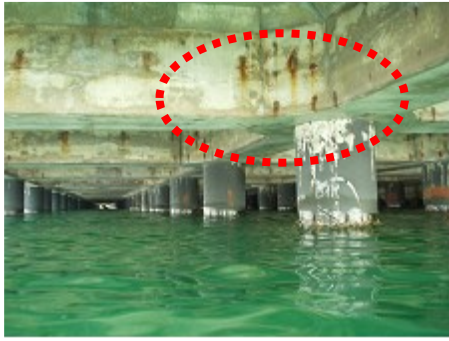
写真 1-25 : 劣化度判定 『c』
