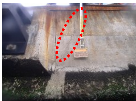
写真 4-09 : 劣化度判定 『c』
