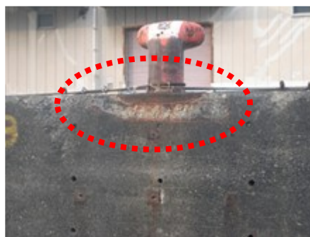
写真 4-06 : 劣化度判定 『b』
