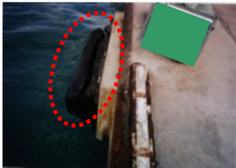
写真 5-03 : 劣化度判定 『a』
