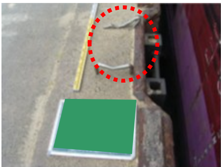
写真 6-03：劣化度判定『a』
