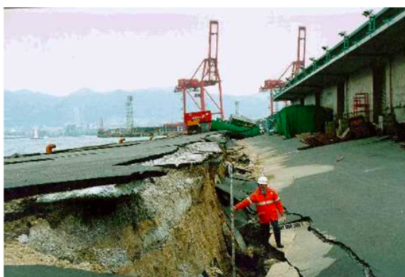
図 5-3 兵庫県南部地震における重力式係船岸の被災事例（写真は左右反転）（基準・同解説 p.1854）
