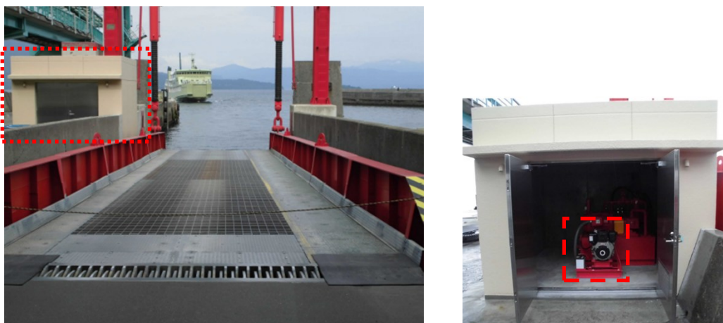
写真 3.4.1 可動橋用の非常用電源の設置事例（左が油圧ユニット室、右が非常用電源）
