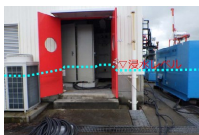
写真 2.2.3 現場変電所の浸水
