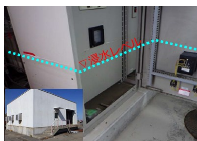
写真 2.2.2 現場変電所の浸水
