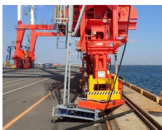
写真 2.5.1 ケーブルリールの落下状況
