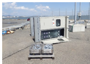
写真 2.2.4 屋外電気設備の被害
