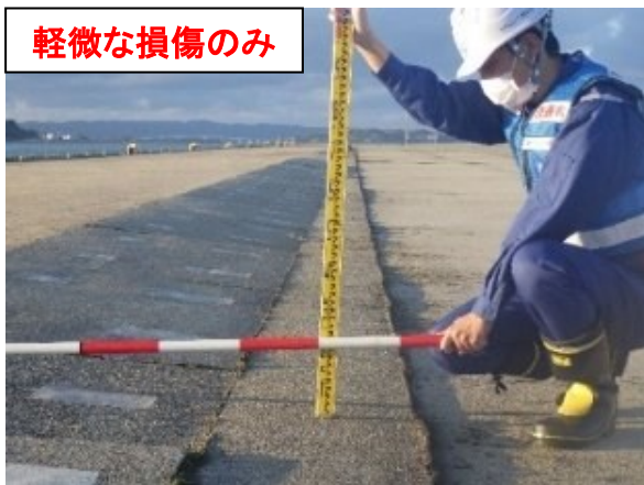
岸壁背後の沈下
