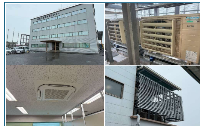
管理棟の省エネルギー（空調設備）
