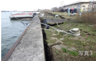
被災状況写真
