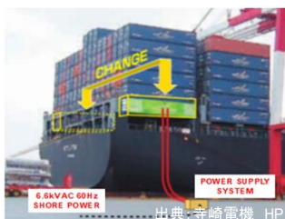
停泊中船舶への陸上電力供給
