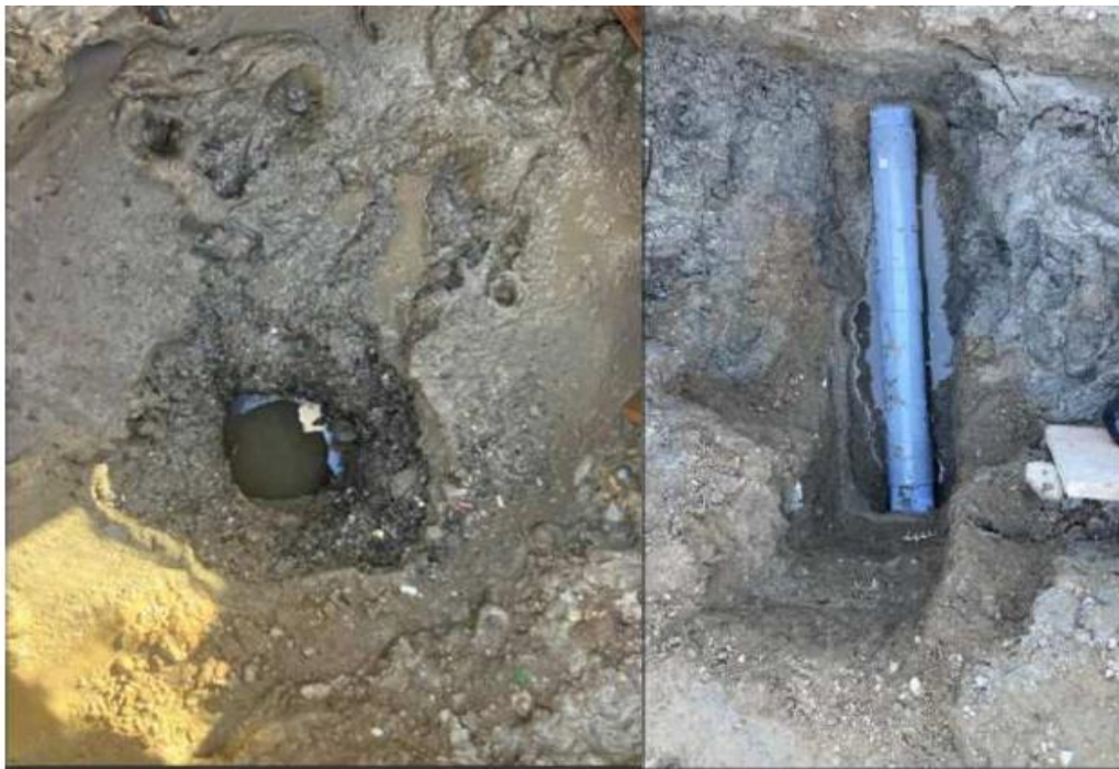
損傷した埋設污水管 φ 150
