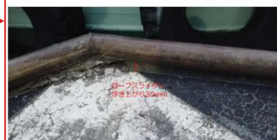
事故発生状況写真
