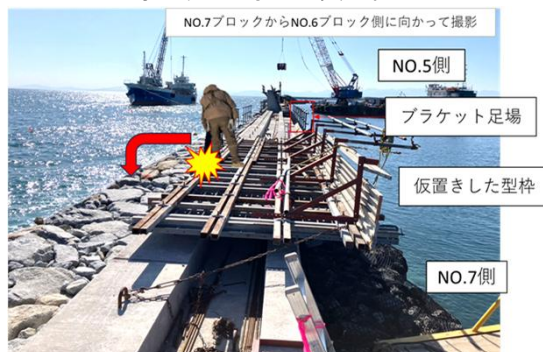
事故発生時の状況
