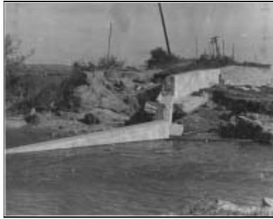
高潮に破壊された護岸（愛知県半田市）
