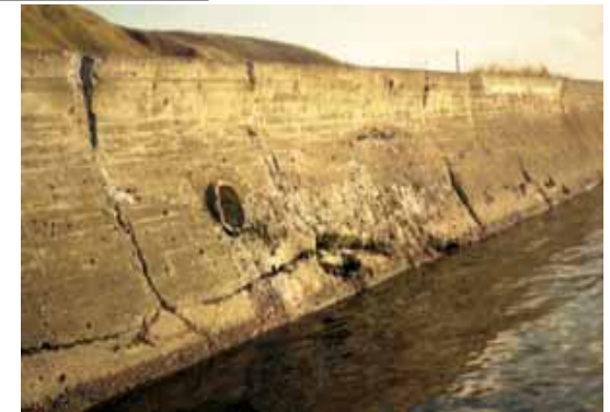
堤防の表法被覆工が損傷
