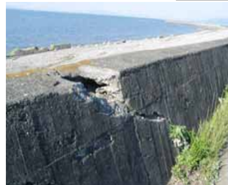
堤防の波返工が損傷
