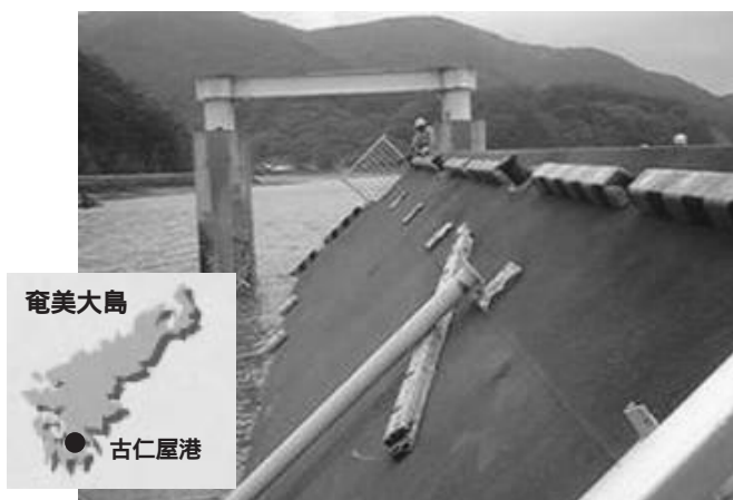
鹿児島県古仁屋港浮棧橋の被災( 台風16号 )
