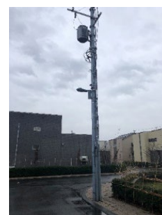
変圧器のある電柱には防犯灯も設置
