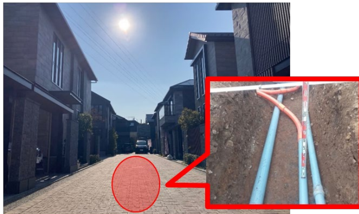
無電柱化まちづくり促進事業を活用した無電柱化の実施事例(東京都世田谷区)
