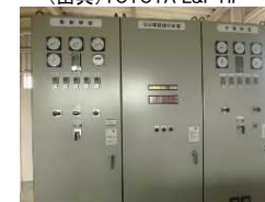
陸電装置(周波数・電圧変換)
