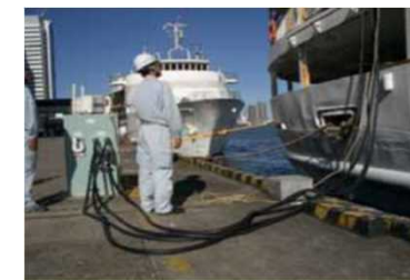
船舶への陸上電力供給
