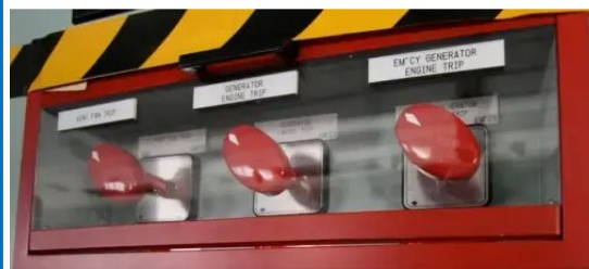
緊急遮断システム
