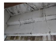
ひび割れや剥離
