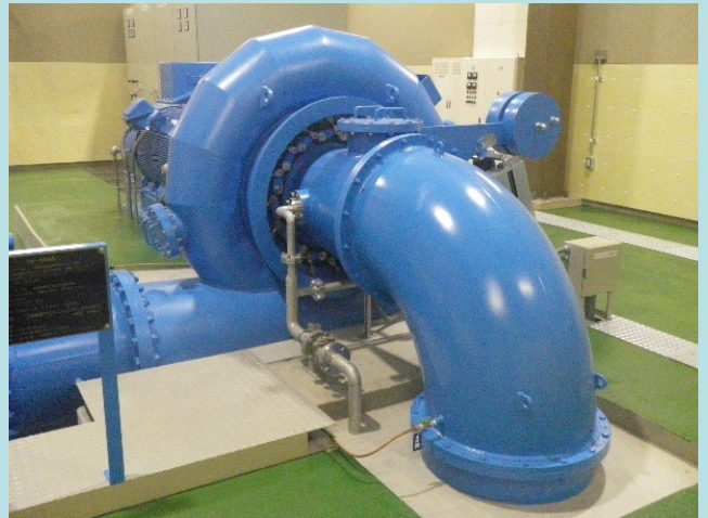
小水力発電施設
