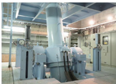
◎ 大滝ダム内部の放流ゲート室
