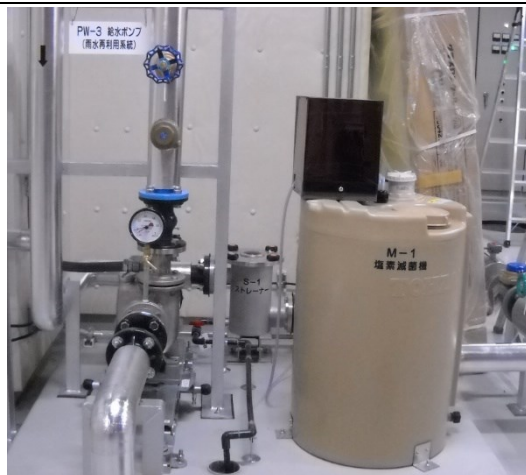
雨水ろ過装置及び消毒装置
