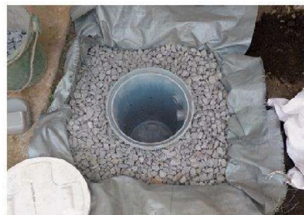
雨水浸透ます
