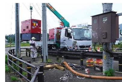
発電機の設置状況
