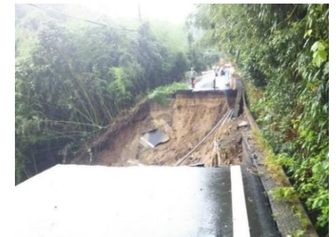
国道249号の土砂崩落 (石川県七尾市)
