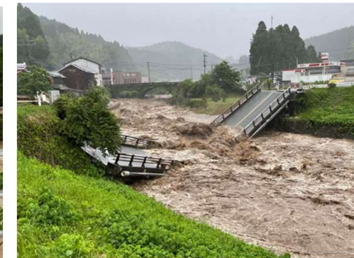
国道445号の橋梁損傷(流出) かみましきぐん やまとちよう (熊本県上益城郡山都町)
