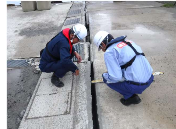
いいだこう すずし いいだまち 飯田港の被災状況調査(石川県珠洲市飯田町)
