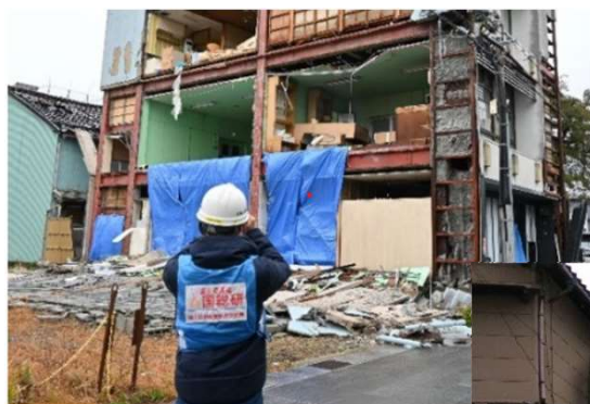
建築物の損壊状況(七尾市)
