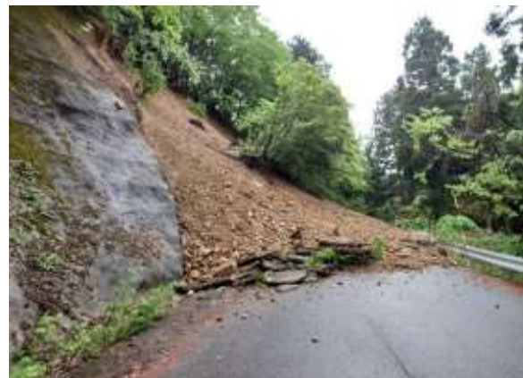
たかや すった すずし わかやままち 県道高屋出田線の法面崩壊(石川県珠洲市若山町)
