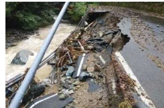
とっとりし 県道鳥取国府岩美線の土砂流出(鳥取県鳥取市)
