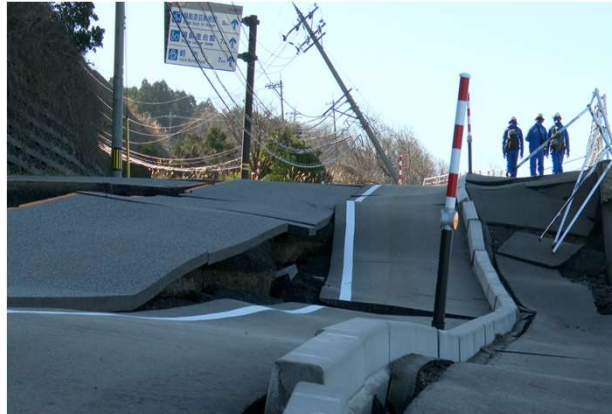
国道249号道の駅千枚田付近(輪島市) (令和6年3月29日14:00国土交通省)
