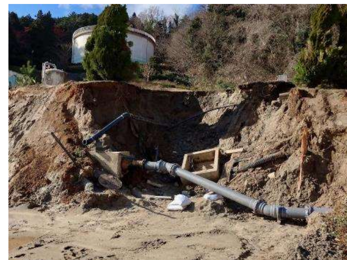
七尾市岩屋浄水場内の水道管の被害状況
