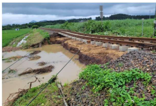
このう JR東日本五能線 路盤流出 やまもとぐん はつぼうしょう (秋田県山本郡八峰町)
