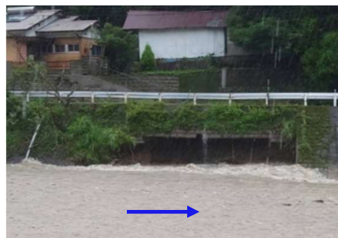
ひがしうすきぐん しはいそん 国道388号の路肩洗掘 (宮崎県東臼杵郡椎葉村)
