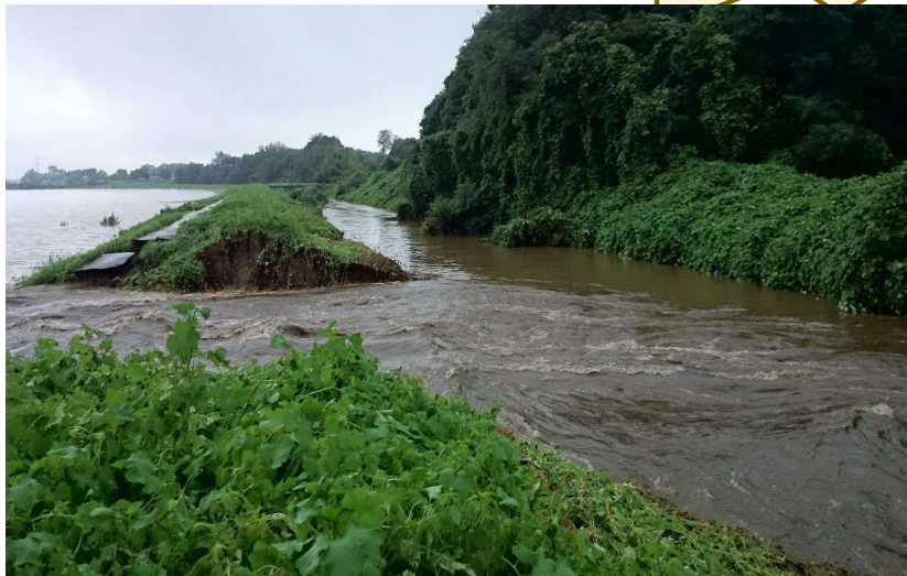
堤防決壊状況
