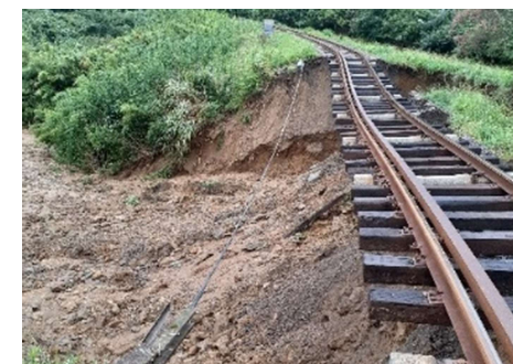
いすみ鉄道いすみ線 路盤流出 いすみぐん おおたきまち (千葉県夷隅郡大多喜町)
