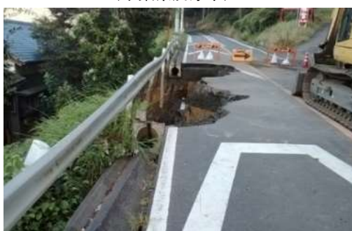
たかはざし 国道461号の土砂崩れ(茨城県高萩市)
