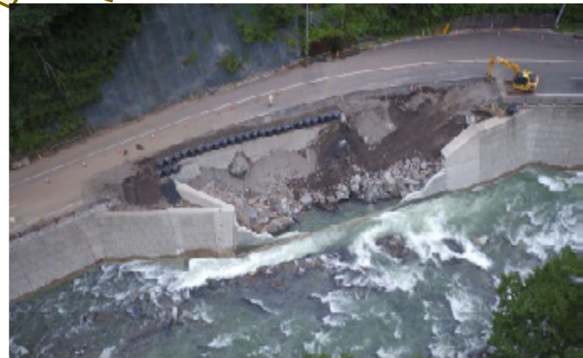
護岸欠損状況
