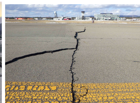
能登空港の被災(輪島市)
