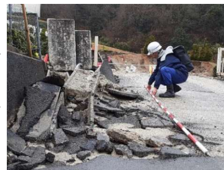
岩屋浄水場の被災(七尾市)
