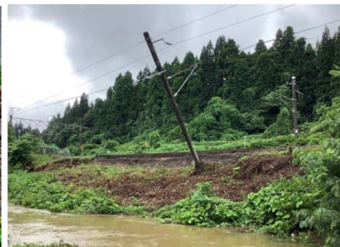
おう JR奥羽本線 路盤流出・電柱傾斜 あきたし (秋田県秋田市)
