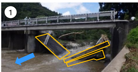
▲被災状況(床版落下・橋脚転倒)
