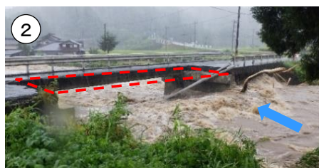
▲氾濫状況(橋梁部)
