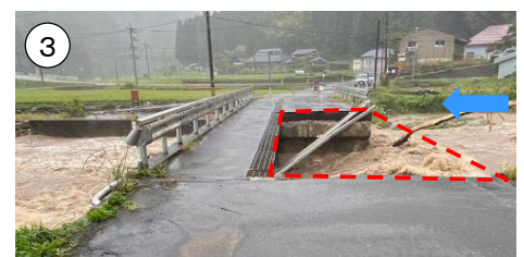
▲氾濫状況(橋梁部)
