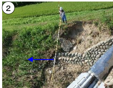
▲ 護岸損壊の状況(竹橋)
