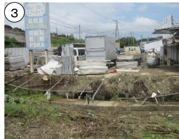
▲ 工業団地浸水の状況(富田)
