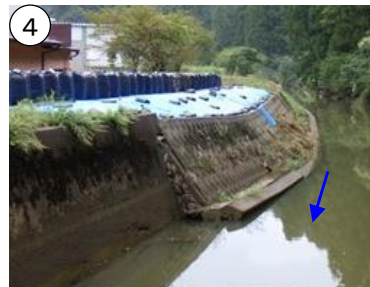
▲ 護岸損壊の状況(富田)
