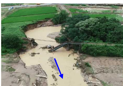
▲JR小白川橋梁被災状況
