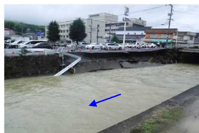
▲ ②護岸の被災状況
