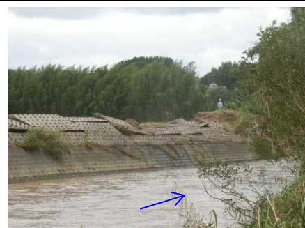
▲ 護岸被災状況
