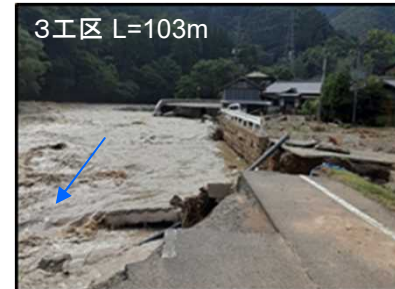
▲第3工区の被災状況
