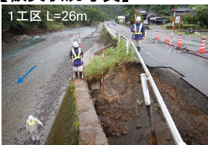
▲第1工区被災状況
