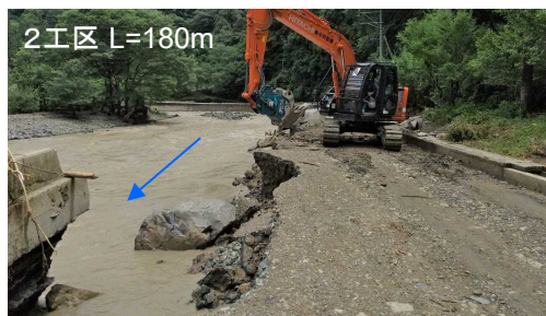
▲第2工区の被災状況
