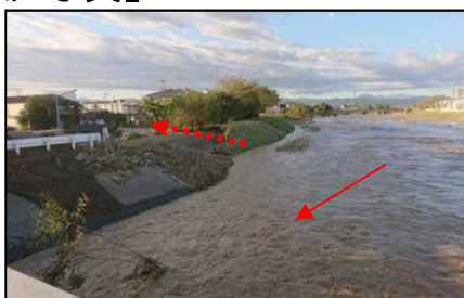
▲②秋山川(大橋上流右岸)決壊箇所状況
