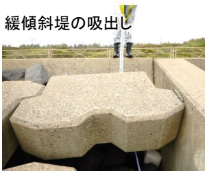
緩傾斜堤の被災
