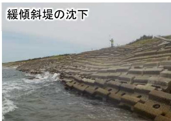
緩傾斜堤の沈下
