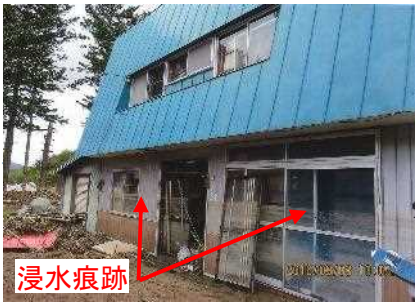
民家への浸水被害状況
