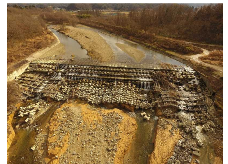
床固工・護床工被災状況
