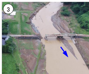
▲橋梁被災の状況
