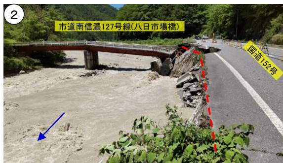
▲橋梁被災の状況(全景)
