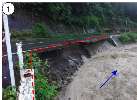
▲護岸崩壊の状況
