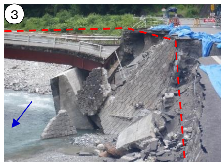
▲橋梁被災の状況(近景)
