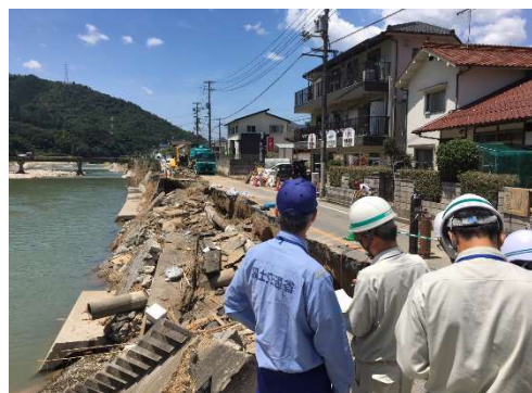
災害緊急調査状況
