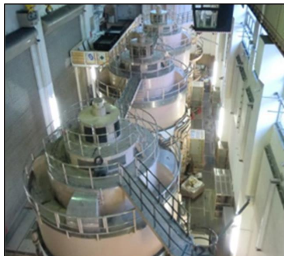
水車発電機(工事前)
