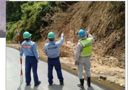
TEC-FORCEとの 被災状況調査の様子 （山形）
