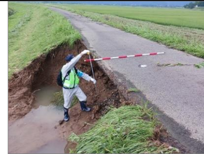
被災状況調査の様子 （秋田）
