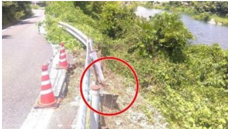
地上写真(法面の損傷)
