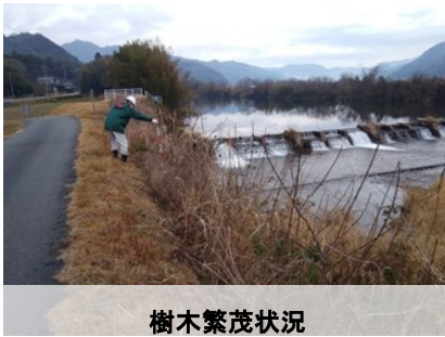
樹木繁茂状況
