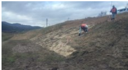
土堤川表法面小段部に湿潤化を確認 (L=60m,B=記録なし,H=記録なし)
