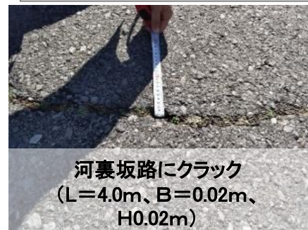
地上写真(亀裂)
