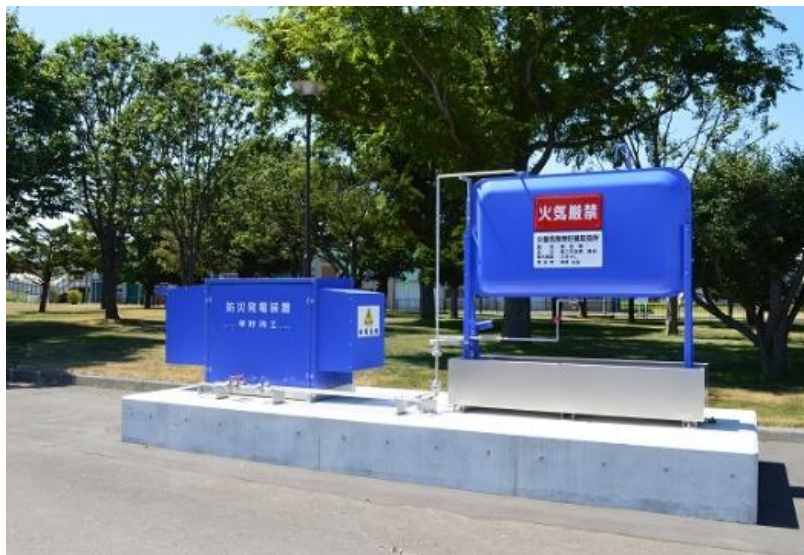
非常用自家発電装置（本社敷地内）
