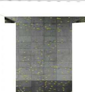
04 合成画像／損傷表示
