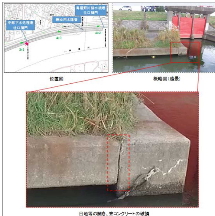
図 5-3 ドローンによる目地等の開き、笠コンクリートの破損の把握
