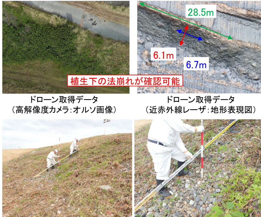
図 2-6 ドローンによる法崩れの確認例 (上：ドローン取得データ、下：地上からの確認結果)
