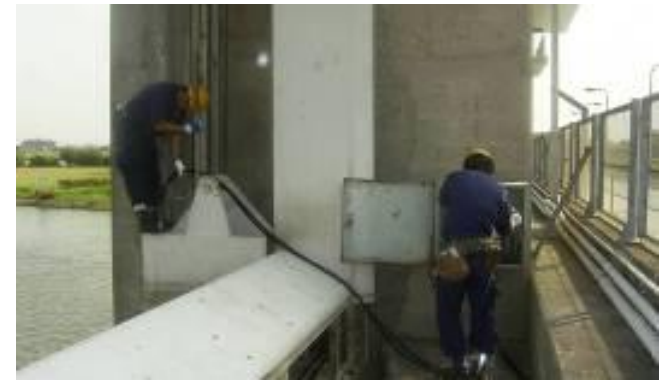
構造物点検による 堰の電気設備の状態把握
