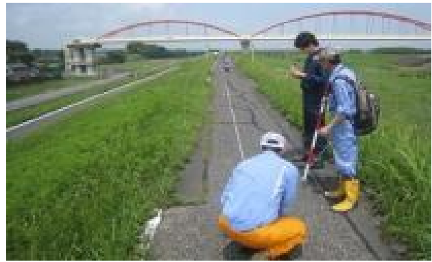
堤防点検による天端亀裂の計測
