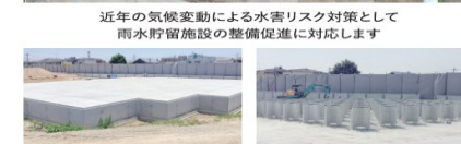
地下雨水貯留槽メルマガ
